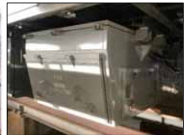
線路設備状態監視 (写真:E131系房総・鹿島エリア)
