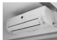
エアコン・室外機
