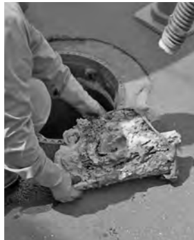
汚水本管に詰まった油の塊
