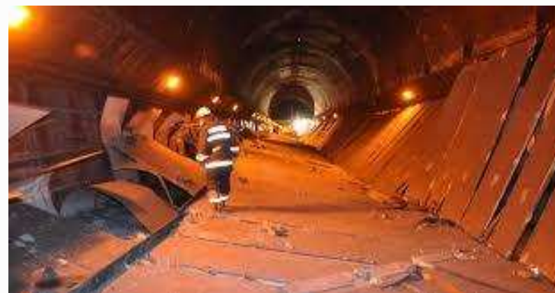
〈中央自動車道笹子トンネル天井崩落事故の様子〉
