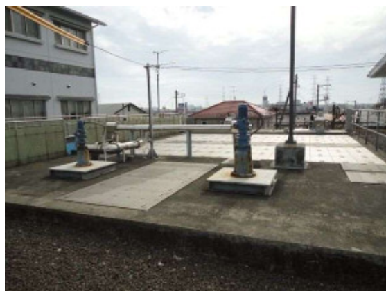
末の松山浄水場機械設備 (フロキュレーター)
