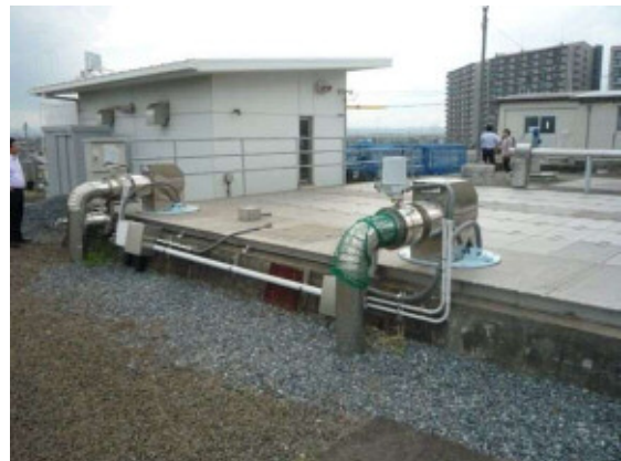
末の松山浄水場機械設備 (ろ過ポンプ)
