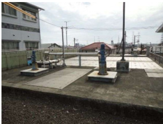
末の松山浄水場機械設備 (フロキュレーター)
