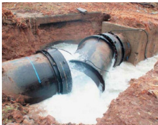
写真：宮城県仙南・仙塩広域水道送水管 伸縮可撓管の離脱（鋼管直径2,400mm） 場所：白石市福岡 出典：東日本大震災の記録（多賀城市総務部交通防災課）
