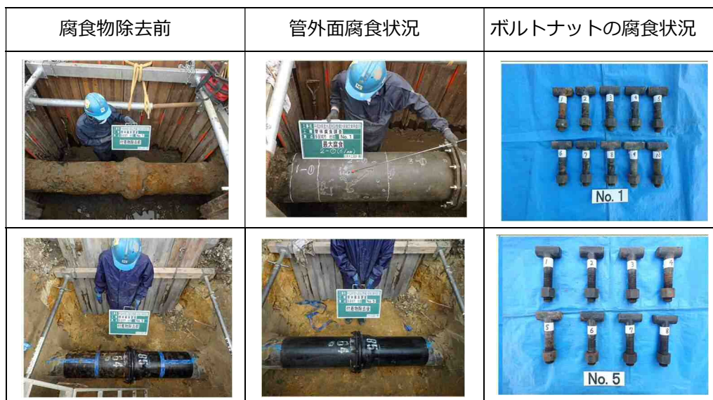
図 4-14 管体腐食度調査状況 (代表例)
