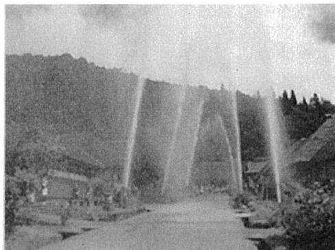
放水銃 28 基の一斉放水（9/1 防災訓練）
